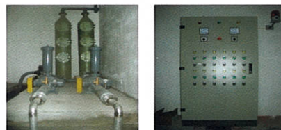
Máy thổi khí và tủ điện
