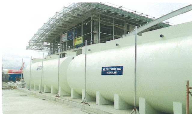
Hệ thống XLNT sinh hoạt - Dự án xây dựng nhà ga Quốc tế - Cảng Hàng không Quốc tế Đà Nẵng
