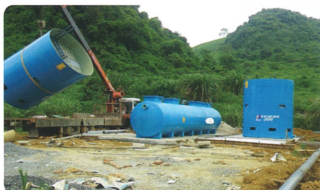
Trạm XLNT TTNC Lợn Thụy Phương - Hòa Bình
