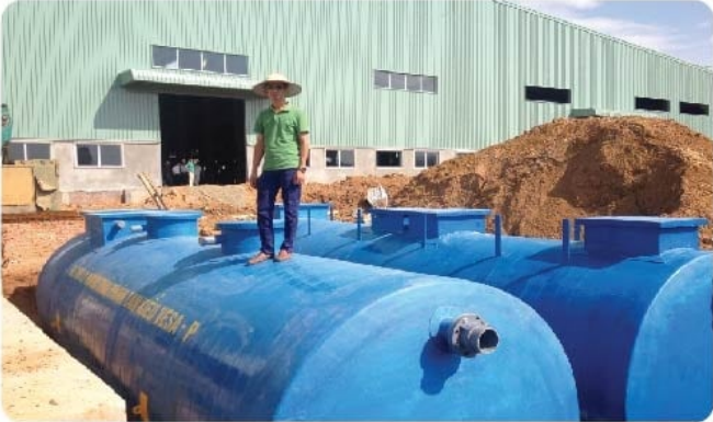
WWTP - Phuong Hoang Xanh- Ha Noi
