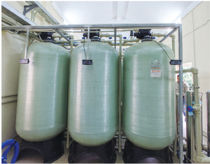
Hệ thống cung cấp nước sạch Khu di tích K9 Công suất: 200m3/ngày.đêm
