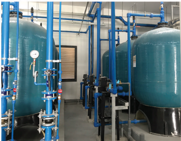
Hệ thống xử lý nước cấp Dự án Mikazuki Spa & Hotel Resort Công suất: 54m3/giờ
