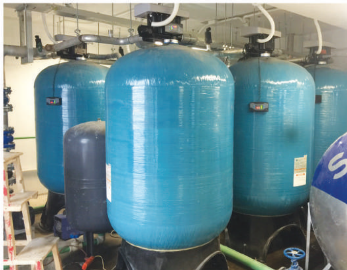
Hệ thống xử lý nước sạch Bắc Hà Công suất: 80m3/giờ
